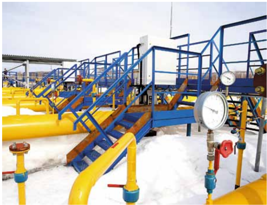
Узел редуцирования газа
